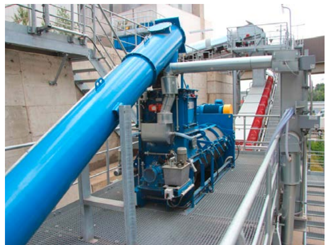
Kontinuierliche Mischanlage zum Befeuchten von Flugasche
